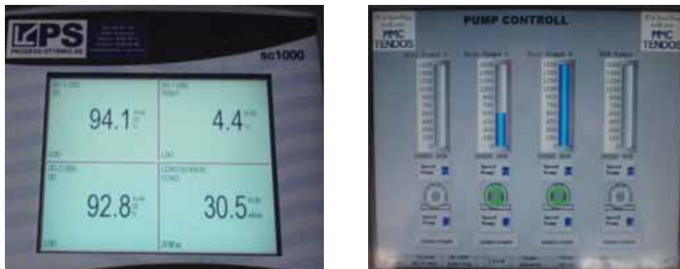
Figur 2. Overvåking av oksygenmetning i kombinasjon med trinnløsregulering av vanngjennomstrømming, begge fra berøringspanel, utgjorde en viktig del for gjennomføringen av forsøk. Begge systemer leses av og styres fra bro.
